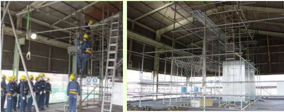
高所体験設備
