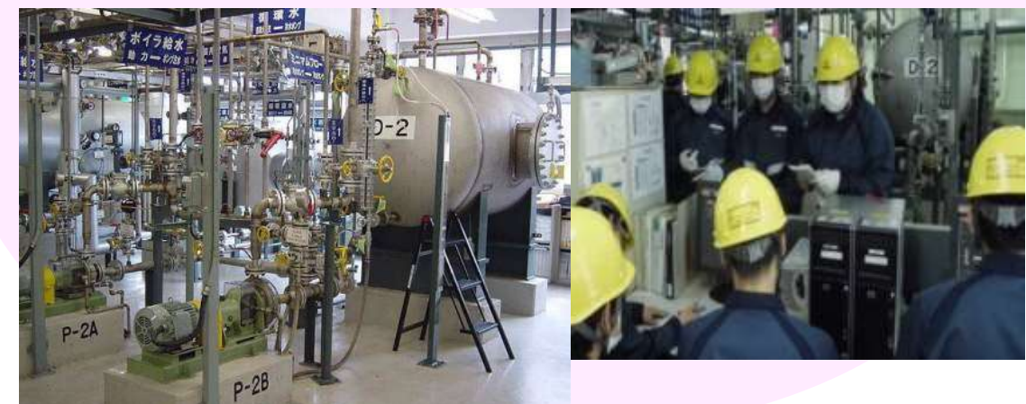
温水循環設備(ミニプラント)
