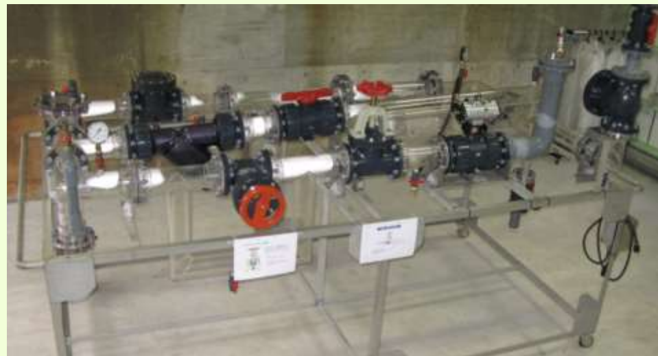
液抜・洗浄体験設備
