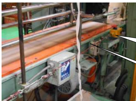
図 190 ベルトコンベアに沿って引き綱を設置した事例
