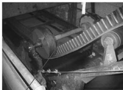
巻き込まれ推定部分 押えローラーとコンベヤー間に巻き込まれたと推定される
